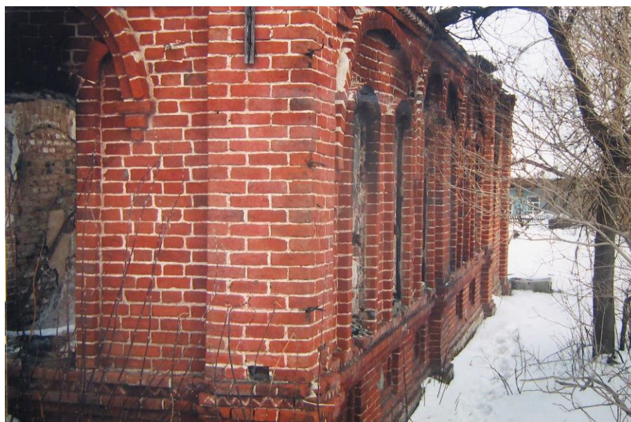
Северная стена дома Кладенова сразу после пожара 10 ноября 2006 года. Фото автора
